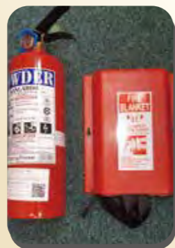
手提滅火筒和滅火氈
